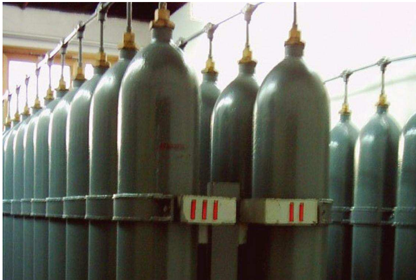
Slika 10. Sustav za potporu rada barokomore (boce komprimiranog zraka i boce kisika).
